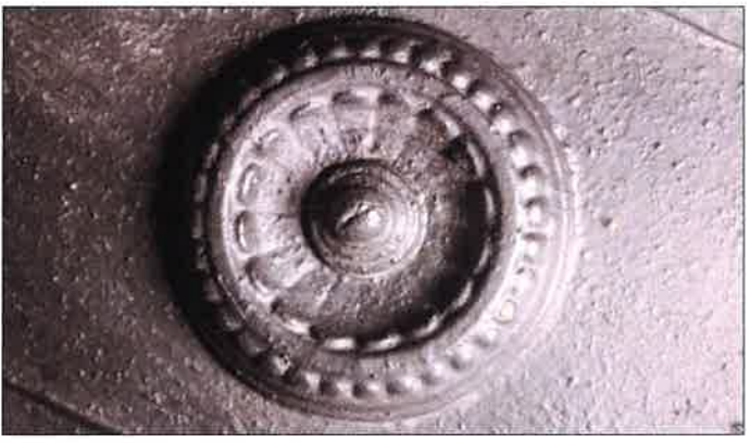
Zdobny element dekoracyjny zamontowany za pomocą sru- by w środkniku belki wspierającej bieg schodowy. (fot. Jakub Andrzejewski, 2019 r.)
