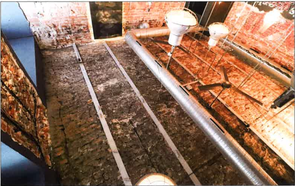
Strop oddzikowy nad pomieszczeniem parteru, wstawiony pod koniec XIX w. lub podczas odbudowy po II wojnie światowej. (fot. Jakub Andrzejewski, 2019 r.)
