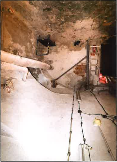
Uszkodzone tynki w piwnicy. (fot. Jakub Andrzejewski, 2019 r.)
