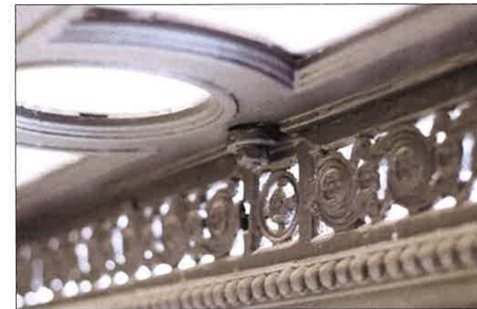
Widok połączenia żeliwnych elementów stopnicy i podstopnicy. (fot. Jakub Andrzejewski, 2019 r.)
