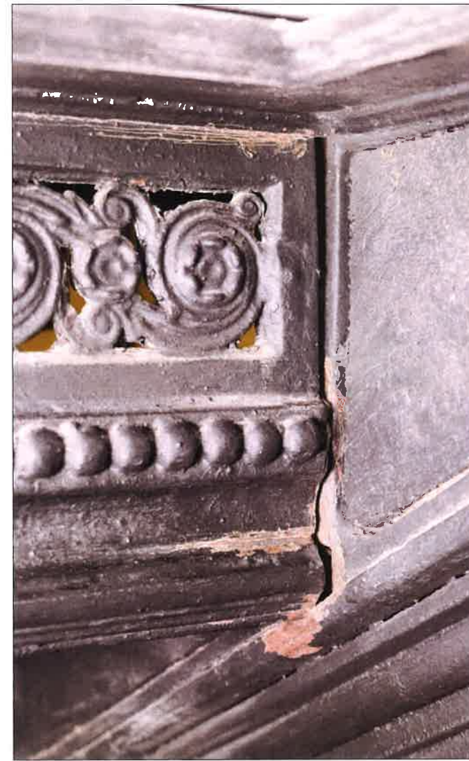
Detal połączenia żeliwnych elementów stopnicy i podstopnicy oraz belki wsporczej i policzka. (fot. Jakub Andrzejewski, 2019 r.)
