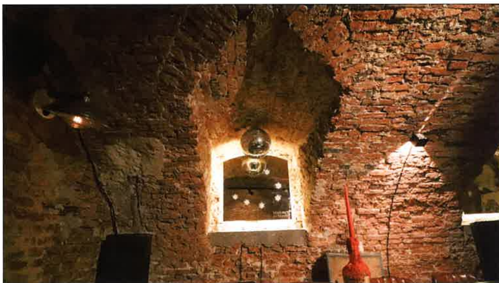
Wtórnie zamurowana luneta otworu okiennego w ścianie zewnętrznej od strony ul. Wierzbowej/ Pl. Teatralnego. (fot. Jakub Andrzejewski, 2019 r.)
