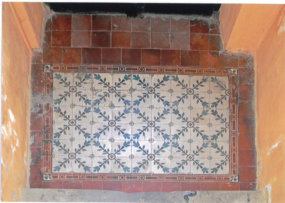
Fot. 8. Główna klatka schodowa - posadzka przy drzwiach wejściowych.
