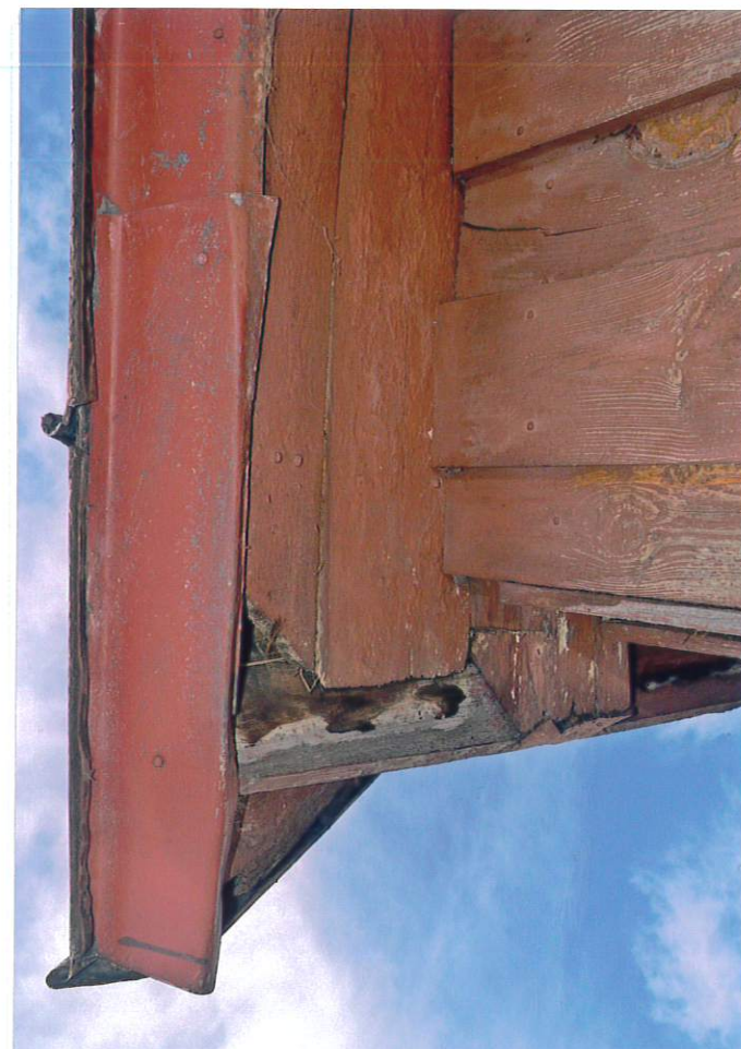
Fot. 4. Zniszczenia podbicia okapu (narożnik południowo-zachodni), 2022.
