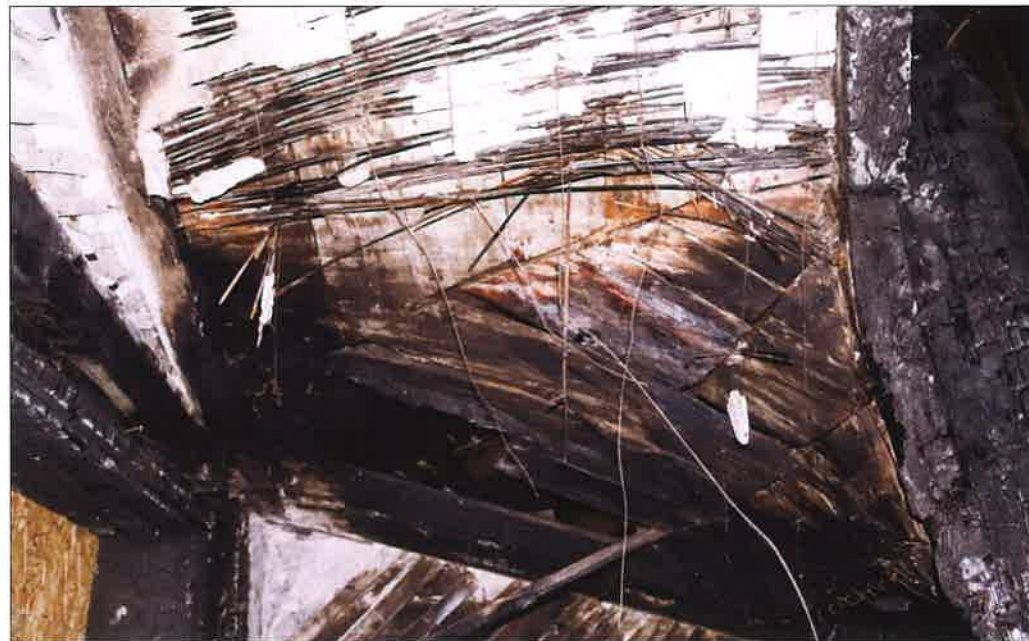
Zniszczony w wyniku pożaru fragment dolnej części biegu w pomieszczeniu klatki schodowej w południowo-wschodniej części budynku. (fot. Jakub Andrzejewski, 2021 r.)
