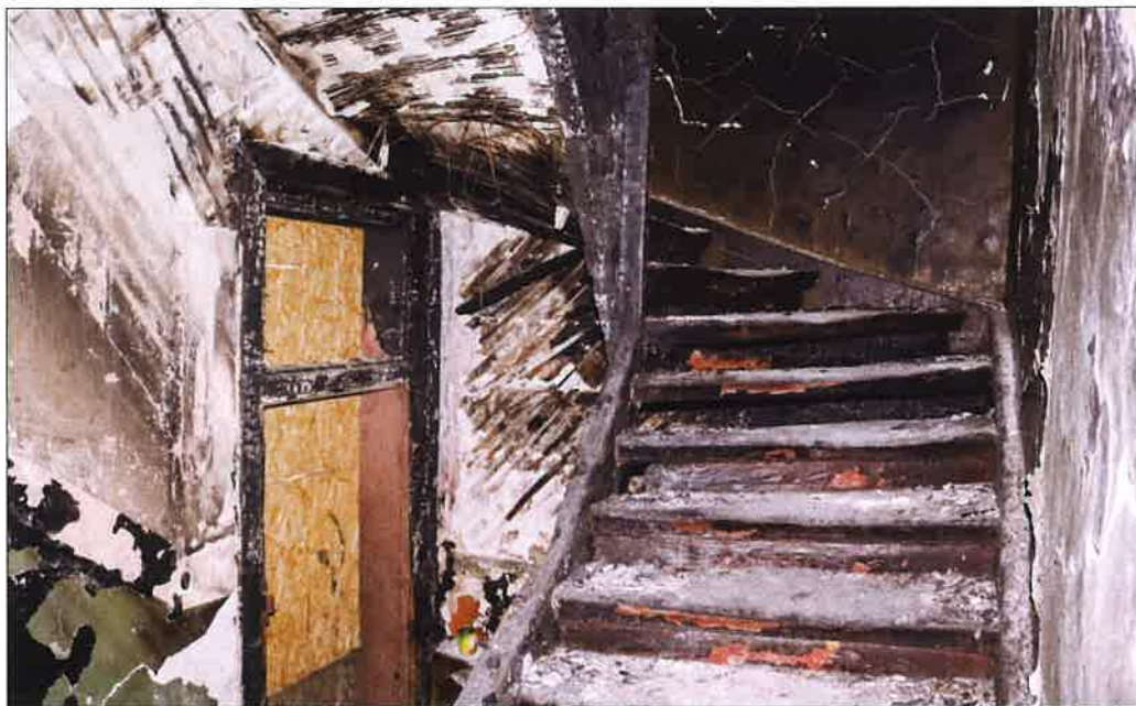
Zniszczona przez pożar klatka schodowa w południowo-wschodniej części budynku, widok środkowej części biegu pomiędzy kondygnacjami. (fot. Jakub Andrzejewski, 2021 r.)
