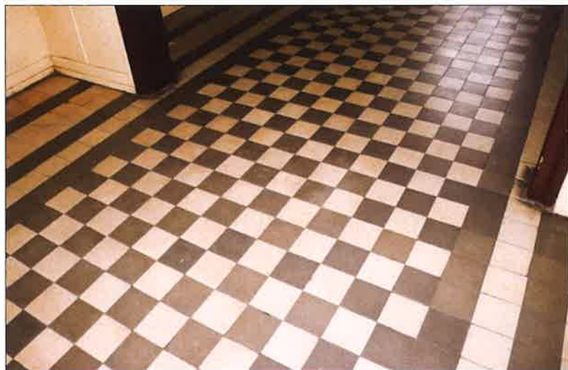
Posadzka terakotowa w głównym pomieszczeniu w środkowej części budynku, w kondygnacji parteru. (fot. Jakub Andrzejewski, 2021 r.)
