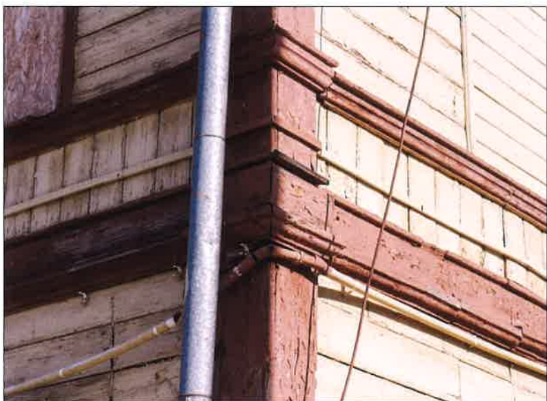
Naroże południowe budynku z widocznym profilowanym gzymsem pomiędzy kondygnacjami. (fot. Jakub Andrzejewski, 2021 r.)
