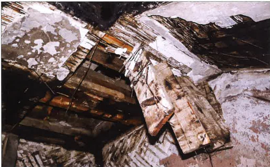
Zniszczony w wyniku pożaru fragment stropu w pomieszczeniu klatki schodowej w południowo-wschodniej części budynku. (fot. Jakub Andrzejewski, 2021 r.)
