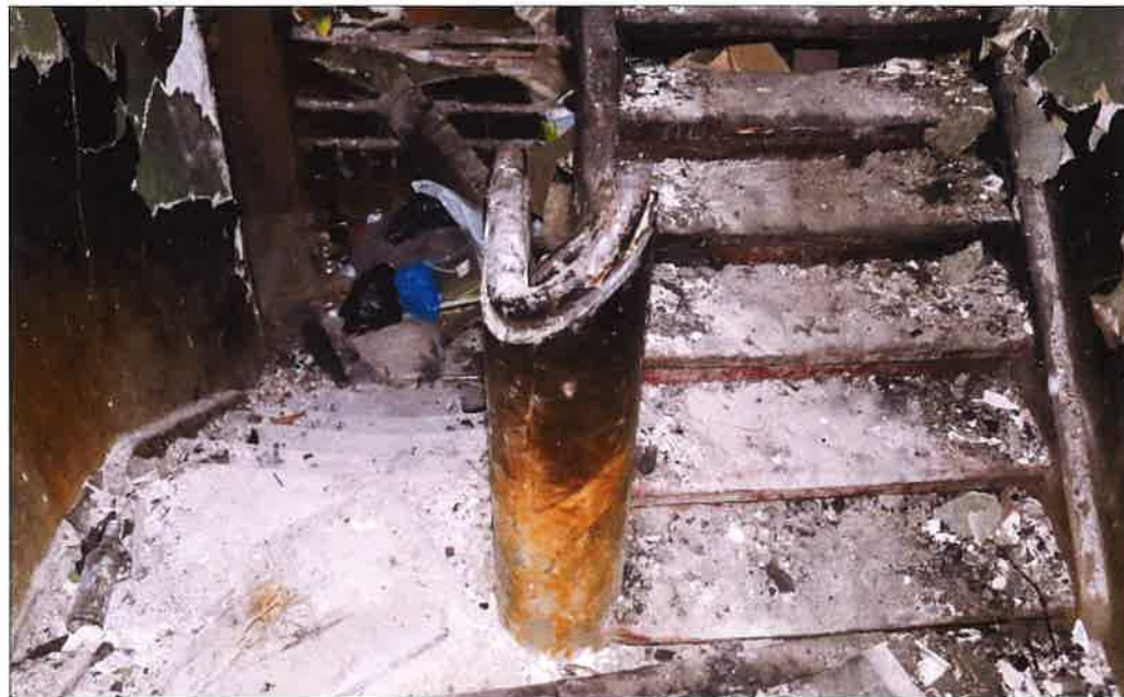
Zniszczona przez pożar klatka schodowa w południowo-wschodniej części budynku, widok biegów w kondygnacji parteru. (fot. Jakub Andrzejewski, 2021 r.)
