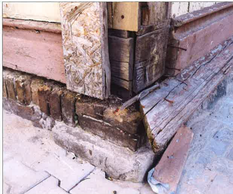
Naroże ryzalitu klatki schodowej w południowo-wschodniej części budynku, z widoczną ścianą fundamentową na której posadowiona jest drewniana konstrukcja ściany nośnej. (fot. Jakub Andrzejewski, 2021 r.)
