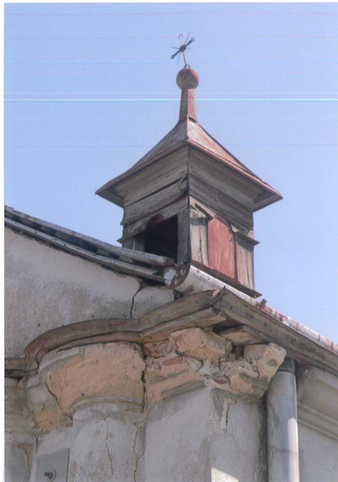
Fot. 5. Korozja gzymsu oraz sygnaturka, 2022.
