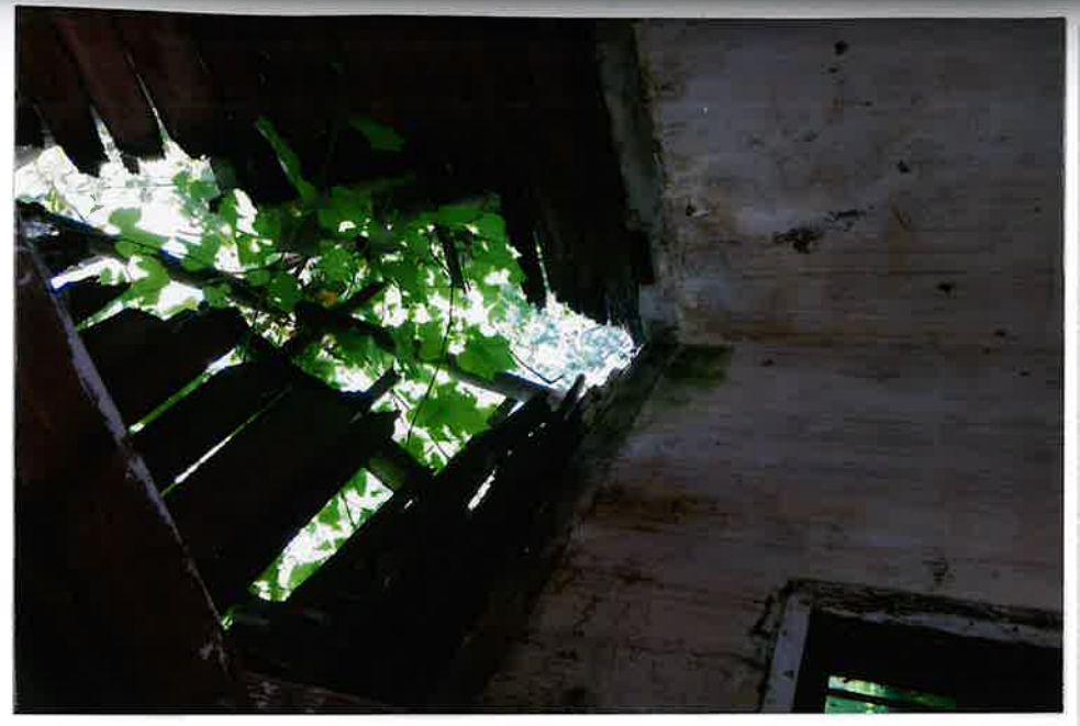
Fot. 10. Zniszczenia dachu w pomieszczeniu południowo-wschodnim.
