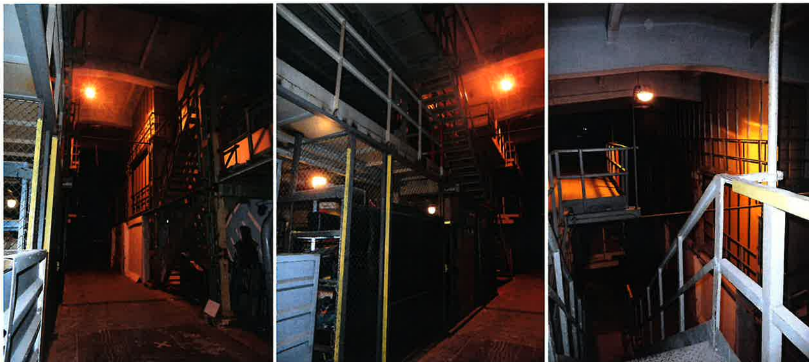
IL. 60, 61. Widoki wnętrza hali technologicznej (6C) wtórnie podzielonej stalowymi pomostami. IL. 62. Widok z pomostu stalowego na konstrukcję stropu i ścianę dobudówki.
