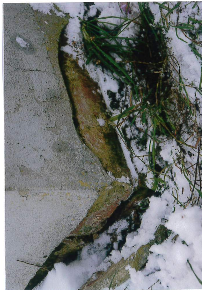
Fot. 6. Korozja narożnika północno-wschodniego.
