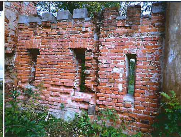
6. Widok muru od pd. – brak wypraw tynkarskich
