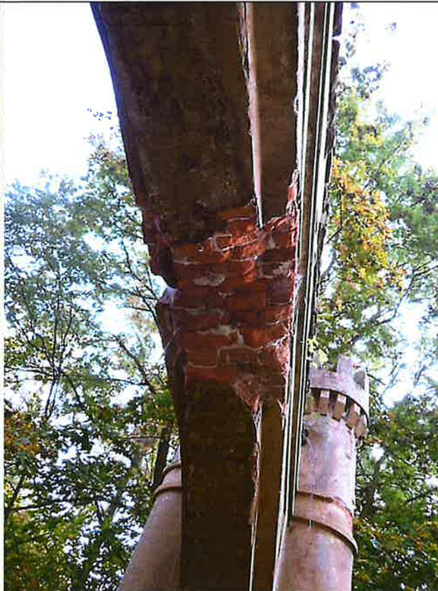
11. Widok ubytku w osi łuku.
