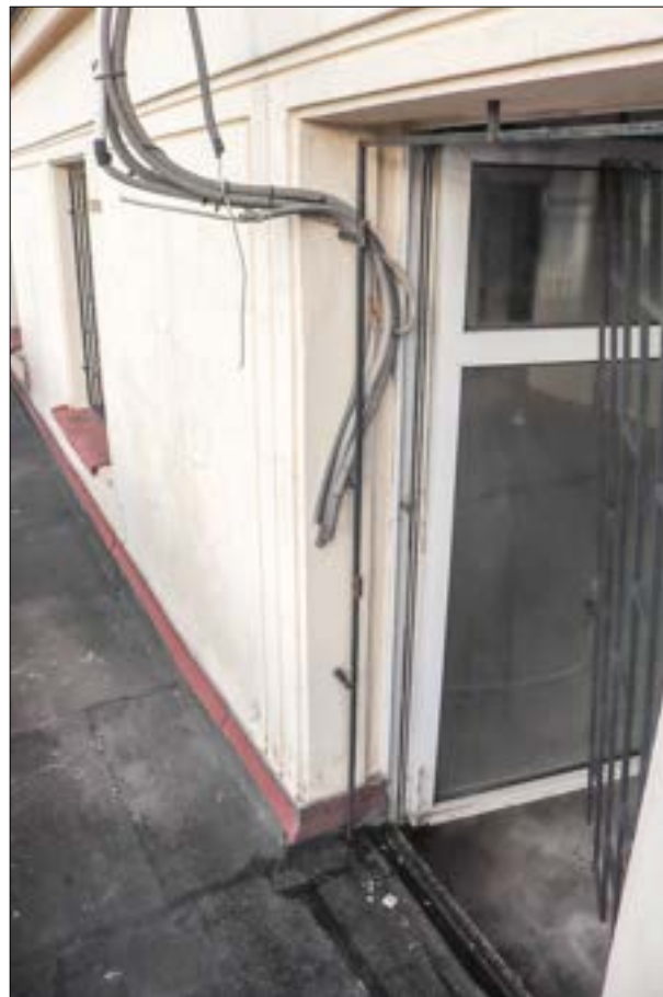
Jedno z wejść na niewielki taras. Widoczna znacząca różnica poziomów pomiędzy tarasem a poziomem podłogi w pomieszczeniach V piętra. (fot. Jakub Andrzejewski, 2025 r.)
