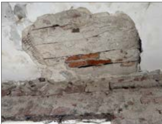
Odspojona pokrycie tynkarskie odsłaniające fragment stropu Kleina z widocznymi podłużnymi bednarkami. (fot. Jakub Andrzejewski, 2025 r.)
