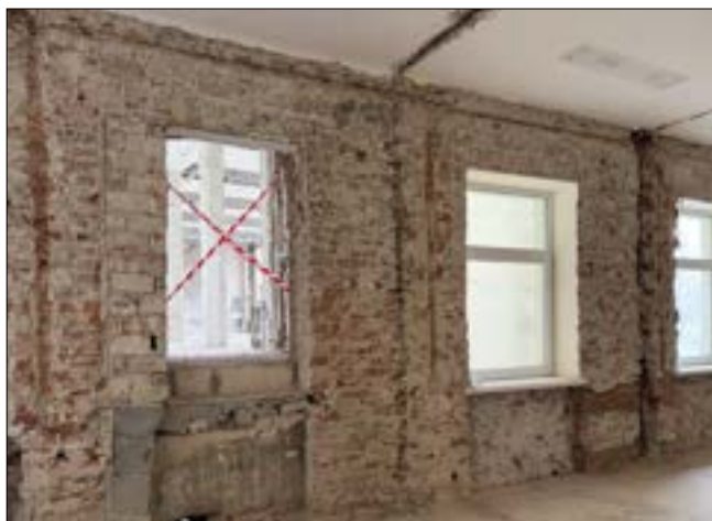
Widoczna różnica poziomów pomiędzy kondygnacjami pomieszczeń w budynku frontowym i oficynie po stronie wschodniej. (fot. Jakub Andrzejewski, 2025 r.)
