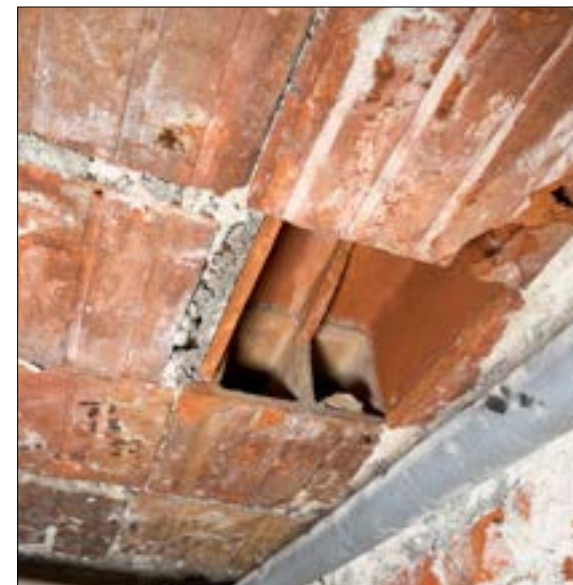
Uszkodzony jeden z pustaków stropowych Ackermana w pomieszczeniach piwnicy. (fot. Jakub Andrzejewski, 2025 r.)
