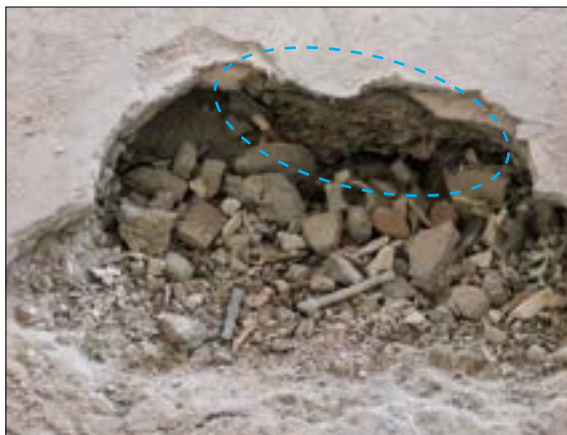
Bruzda w szlachcie betonowej posadzki, widoczna suprema pod warstwą betonu. (fot. Jakub Andrzejewski, 2025 r.)
