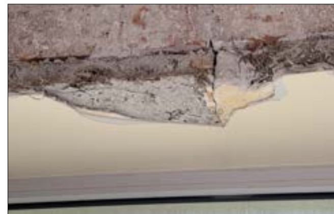
Fragment supremy widoczny w nadprożu okiennym. Pozostałość po oryginalnie stosowanym ociepleniu budynku od strony wewnętrznej. (fot. Jakub Andrzejewski, 2025 r.)
