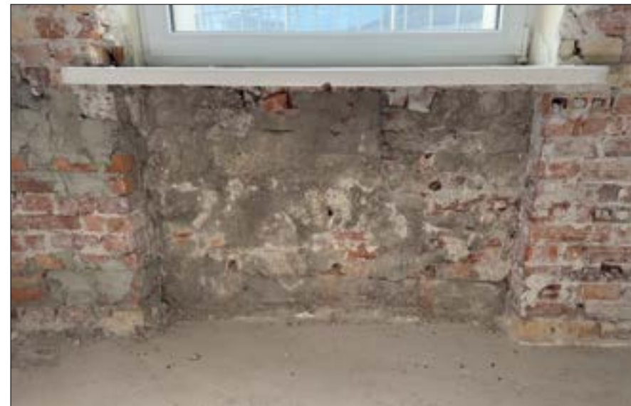
Pod skutą warstwą wyprawy tynkarskiej widoczne ślady płyt cementowo-wiórowych (supremy) zastosowanych pierwotnie do ocieplenia ściany od wewnątrz w kondygnacji V piętra. (fot. Jakub Andrzejewski, 2025 r.)
