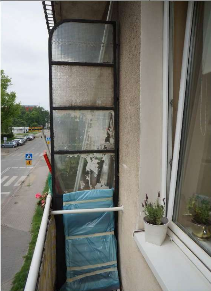
Oryginalne przepierzenie balkonu od strony fasady.
