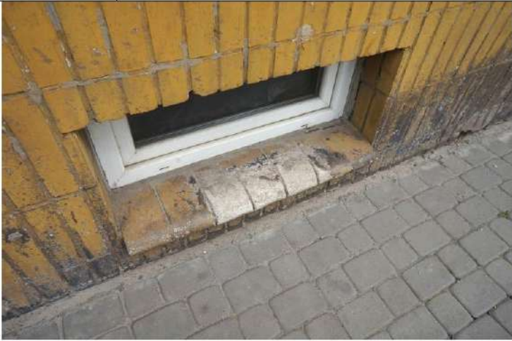
Pomalowana żółtą farbą cegła klinkierowa w przyziemiu. Widoczne kształtki przy okienku piwnicznym.
