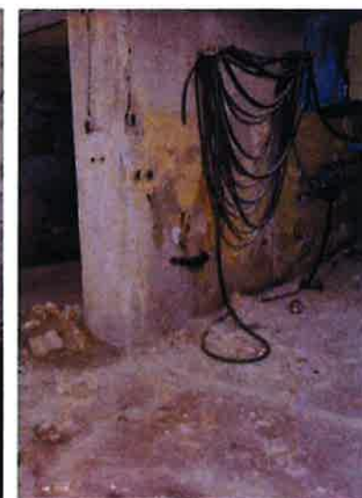
instalacja wodociągowa przy wjeździe
