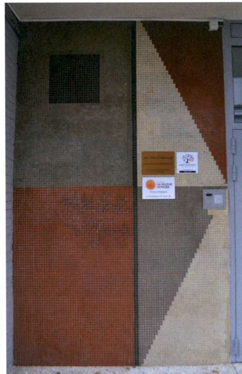
II. 62 Mozaika przy głównym wejściu do budynku, przesłonięta tablicami informacyjnymi, uszkodzona w wyniku montażu domofonu
