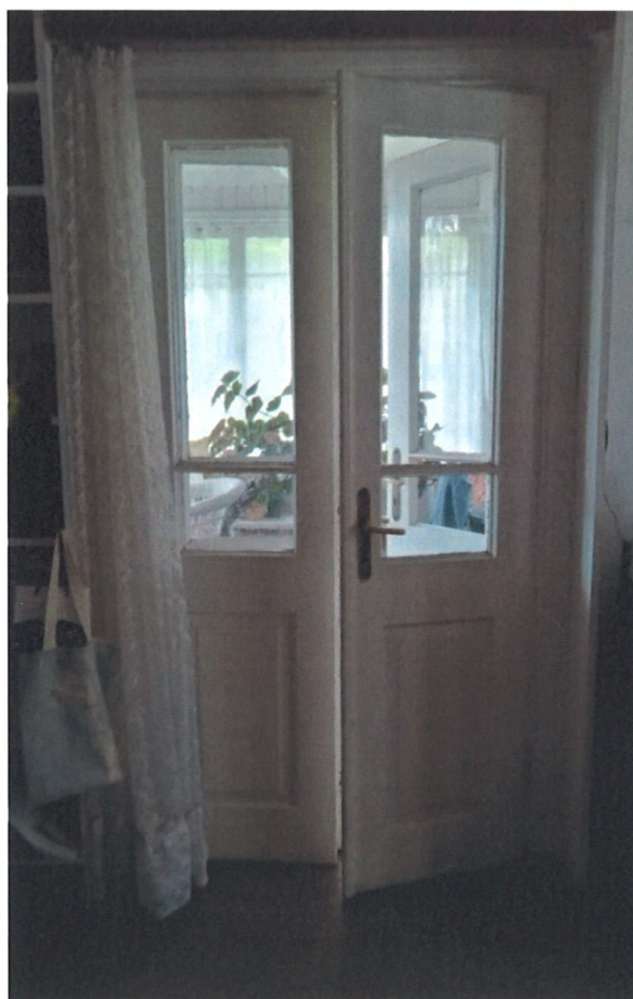
13. Stolarka drzwiowa wewnętrzna – wyjście na werandę.
