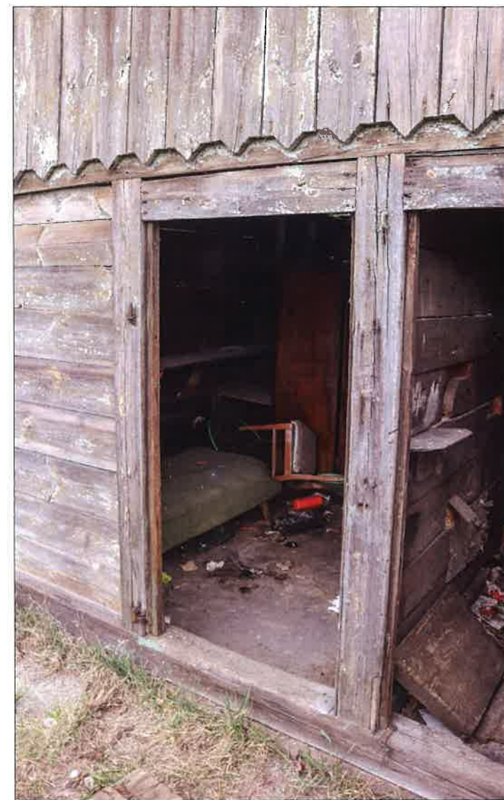
Widok pomieszczenia po południowej stronie budynku, widoczny brak skrzydła drzwiowego. (fot. Jakub Andrzejewski, 2021 r.)
