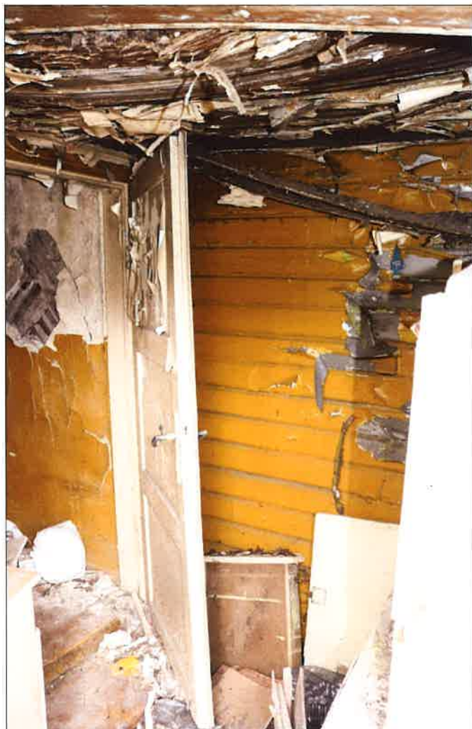
Pomieszczenie przedsionka w przybudówce po zachodniej stronie budynku. Widoczny zawalający się sufit. (fot. Jakub Andrzejewski, 2021 r.)
