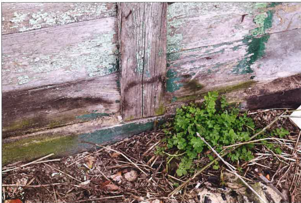
Belka podwalinowa w ścianie elewacji południowo-zachodniej. (fot. Jakub Andrzejewski, 2021 r.)
