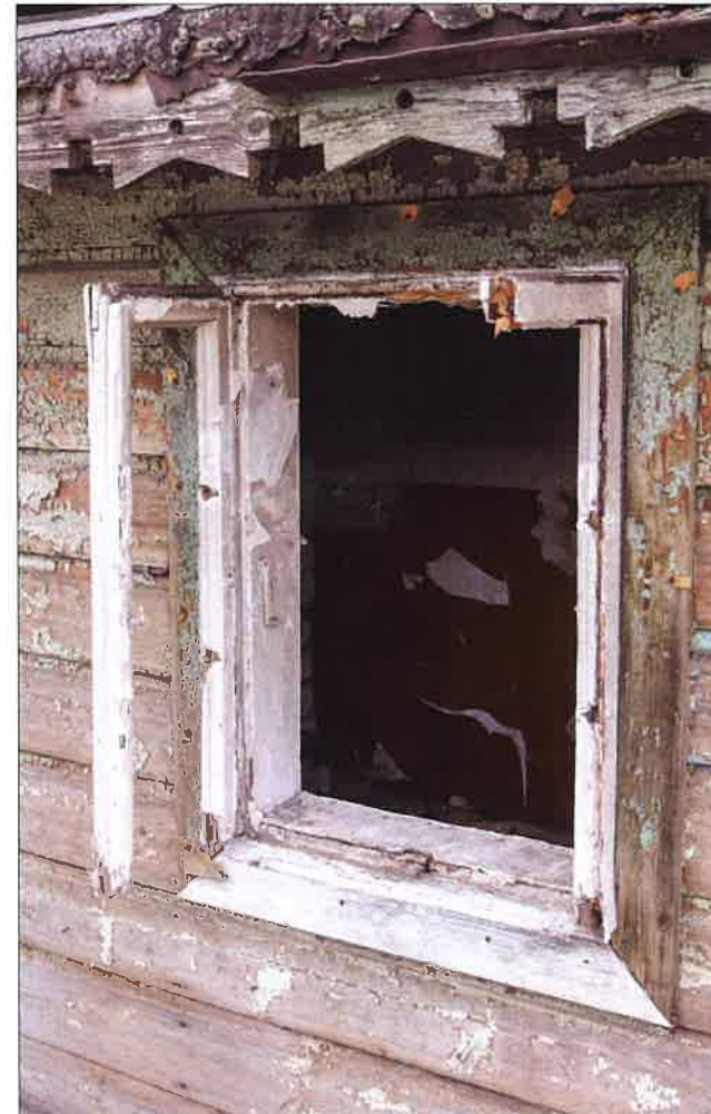
Zniszczone okno w elewacji południowo-zachodniej. (fot. Jakub Andrzejewski, 2021 r.)
