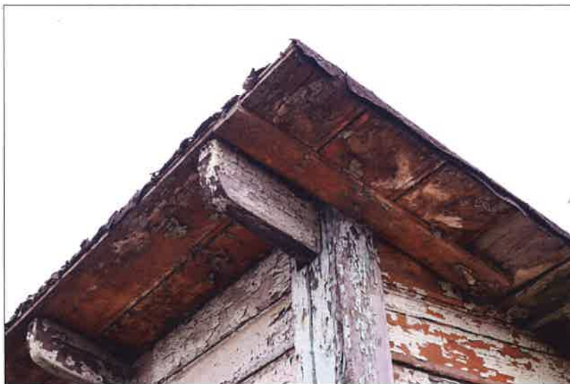
Detal naroża północnego przybudówki na styku z połacią dachową. (fot. Jakub Andrzejewski, 2021 r.)
