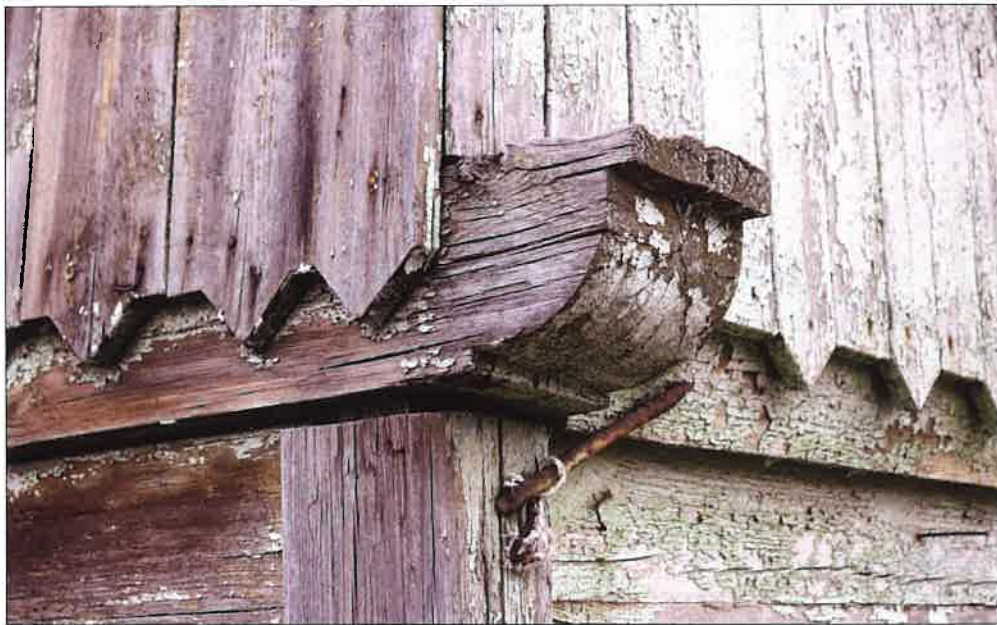
Naroże wschodnie budynku gospodarczego, widoczna belka (oczek) oraz opierzenie z desek układanych na przylgę. (fot. Jakub Andrzejewski, 2021 r.)
