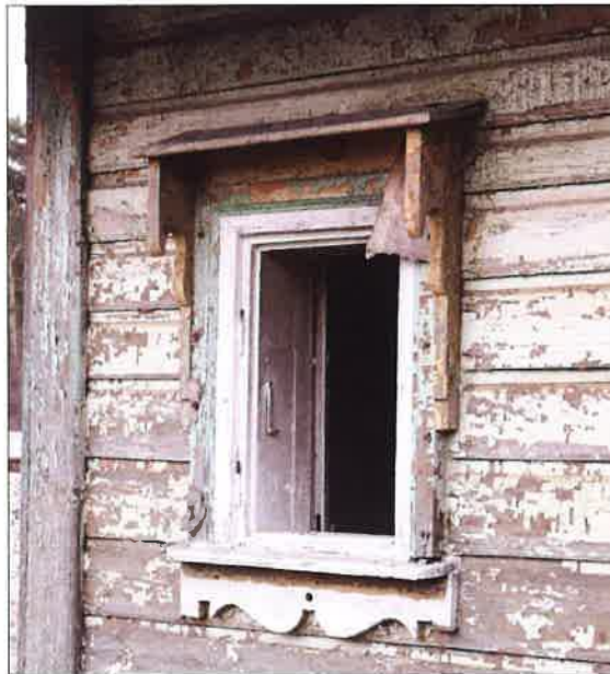
Zniszczone okno w elewacji północno-zachodniej. (fot. Jakub Andrzejewski, 2021 r.)
