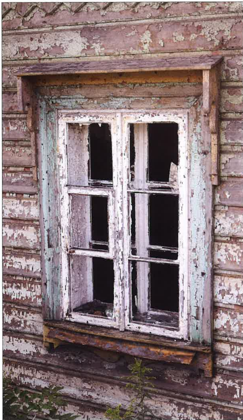
Zniszczone okno w elewacji północno-wschodniej. (fot. Jakub Andrzejewski, 2021 r.)
