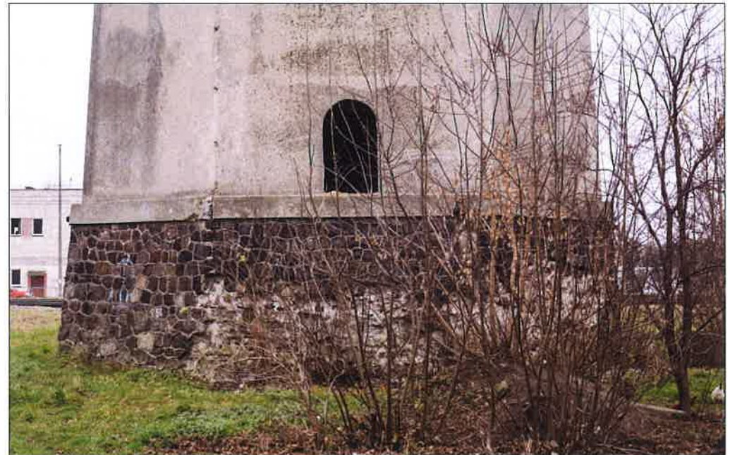
Przyziemie wieży po zachodniej stronie, z widocznymi uszkodzeniami części cokołowej. (fot. Jakub Andrzejewski, 2021 r.)
