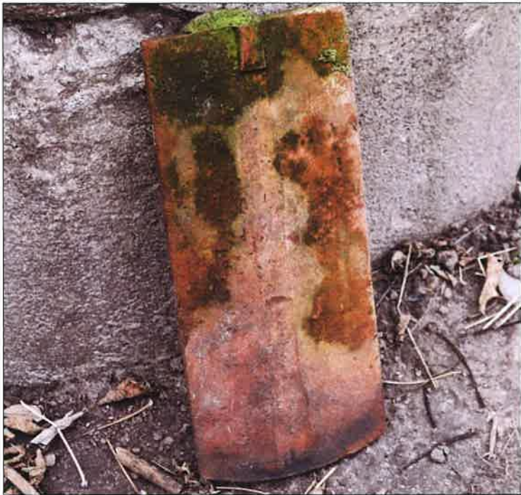
Widok dachówki ceramicznej karpiówki pochodzącej z uszkodzonego dachu wieży. (fot. Jakub Andrzejewski, 2021 r.)
