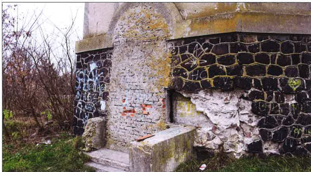
Wtórnie zamurowane wejście do budynku, widoczne uszkodzenia części cokołowej licowanej kamieniem łupanym i łamanym. (fot. Jakub Andrzejewski, 2021 r.)
