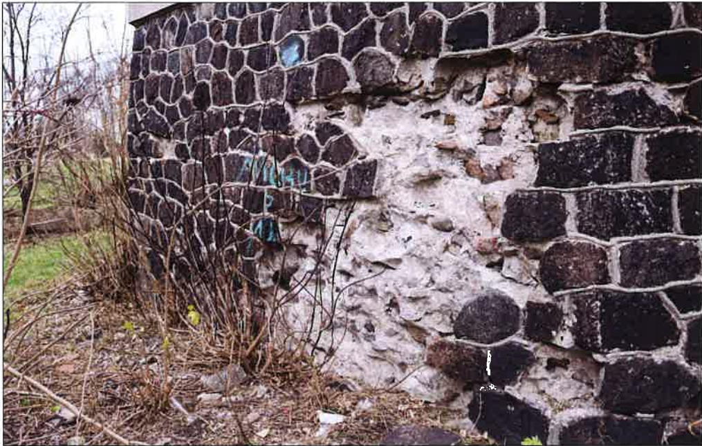
Widok fragmentu uszkodzonego cokołu kamiennego w elewacji południowej. (fot. Jakub Andrzejewski, 2021 r.)
