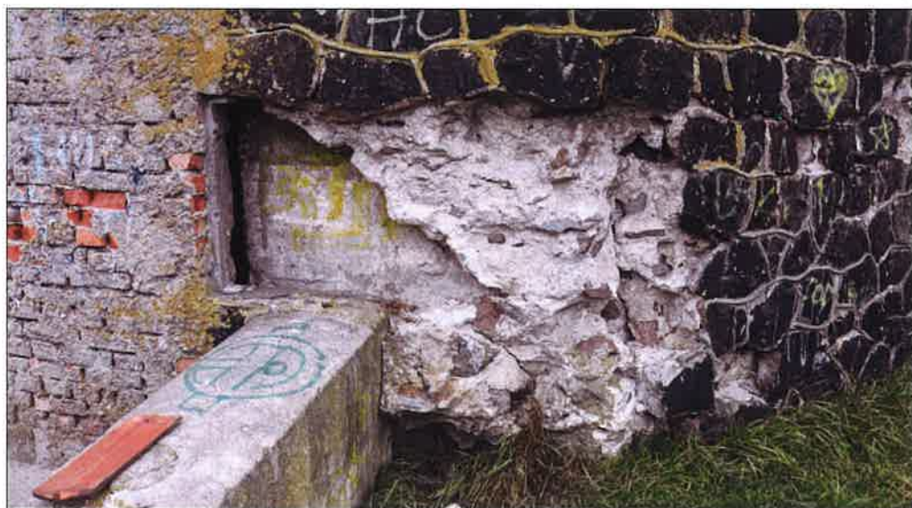
Widok uszkodzeń cokołu wykonanego z kamienia łupanego i łamanego, widoczny w głębi odsłonięty fragment żelbetowej ściany. (fot. Jakub Andrzejewski, 2021 r.)
