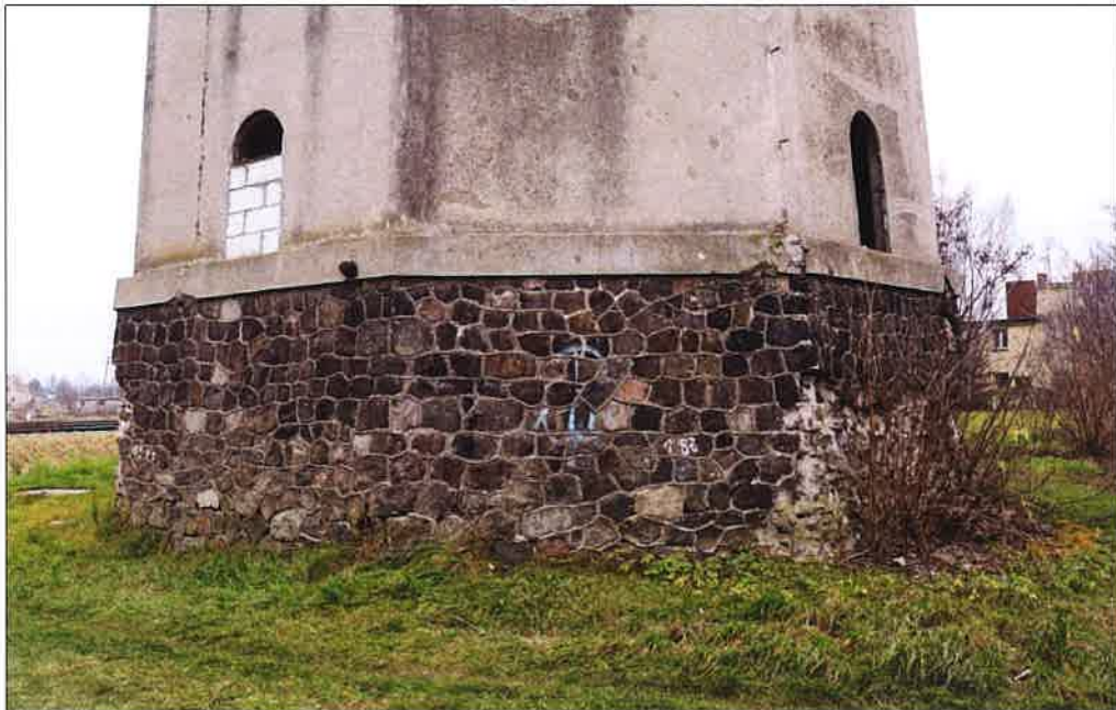
Przyziemie wieży po północno-zachodniej stronie, z widocznymi uszkodzeniami części cokołowej. (fot. Jakub Andrzejewski, 2021 r.)
