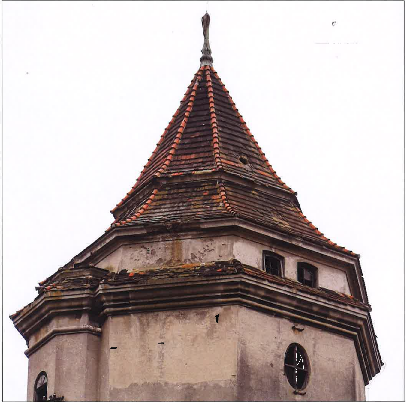
Widok północno-wschodniej części elewacji na wysokości gzymsu pomiędzy dachem, a częścią głowicy wieży; widoczny ślad po eksplozji pocisku, najprawdopodobniej ze stycznia 1945 r. (fot. Jakub Andrzejewski, 2021 r.)
