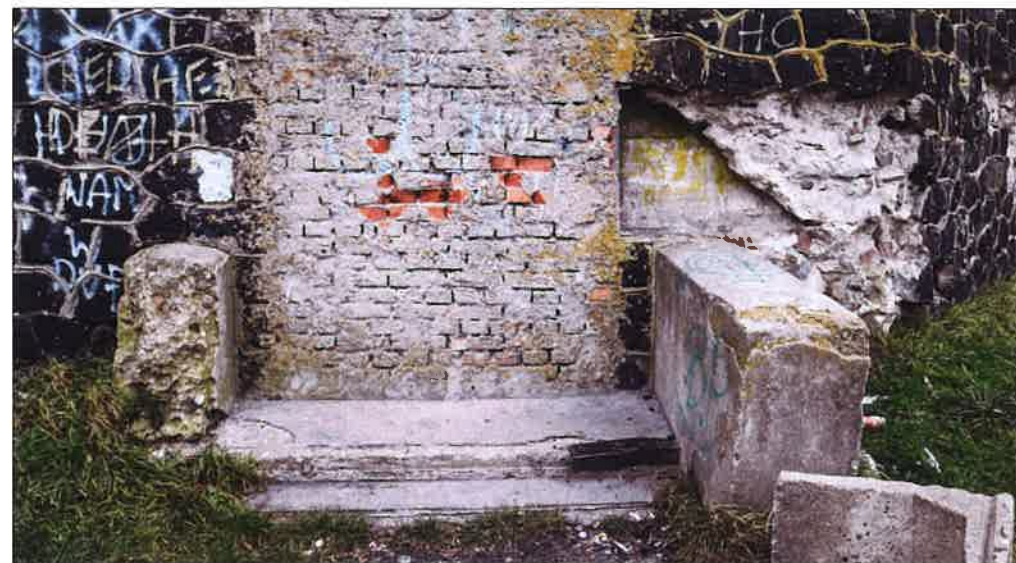
Uszkodzenia ściany przy wejściu: po lewej żelbetowej części ściany schodów, po lewej kamiennego licowania wysokiego cokołu elewacji. (fot. Jakub Andrzejewski, 2021 r.)
